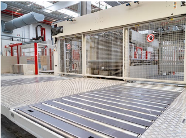
Abb. 14 Arbeitsbereich mit rutschfesten Standflächen und ausgekleideten Rollengängen
