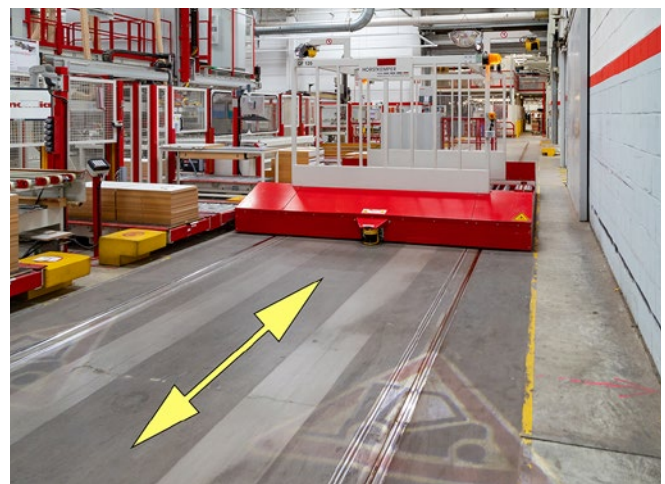
Abb. 85 Querverschiebewagen mit Laserscanner und Projektion der Piktogramme auf Boden „Achtung Staplerverkehr“
