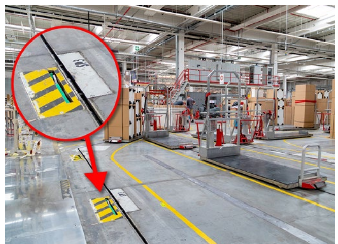
Abb. 89 Auskoppelstelle des Schleppkettenförderers
